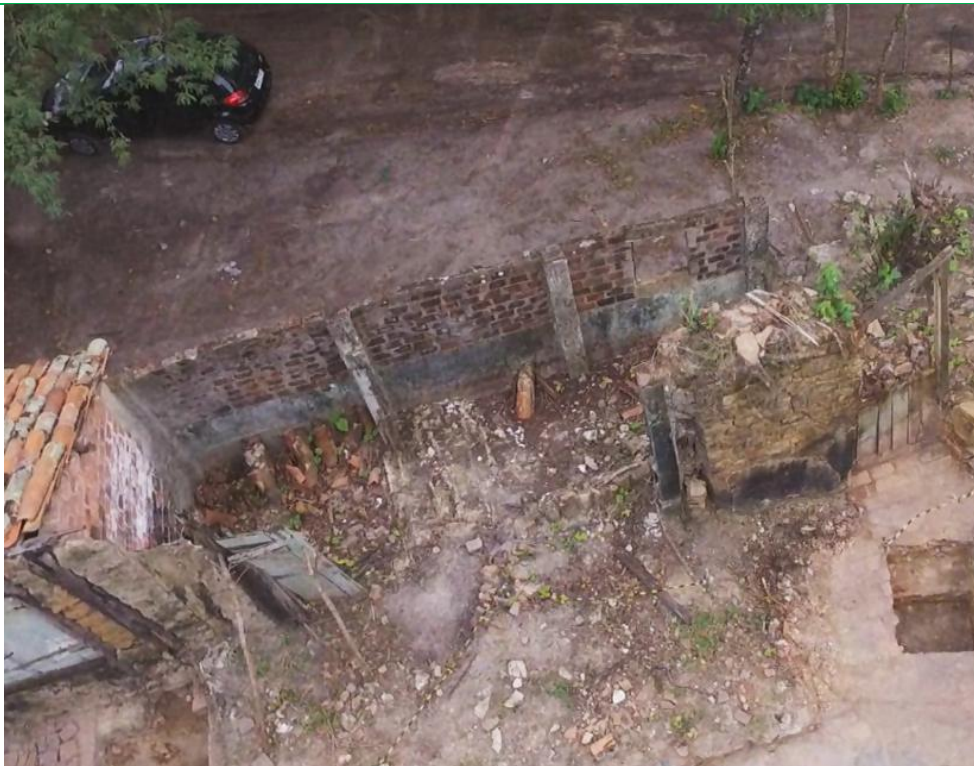
Figura 111: Efeitos da degradação atual
