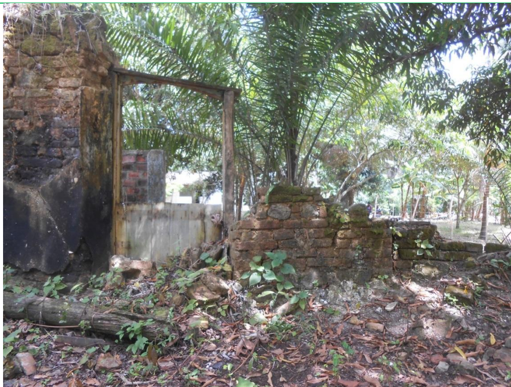
Figura 110: Efeitos da degradação atual
